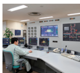
▲中央監視システム
