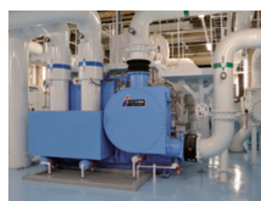
▲ターボ冷凍機
